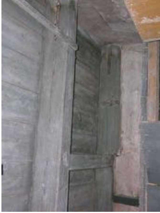
Afbeelding 102. Detail van de balklaag met raveling.
